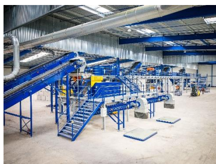
Exemple de ligne de traitement de déchets conçue par MTB Manufacturing.
